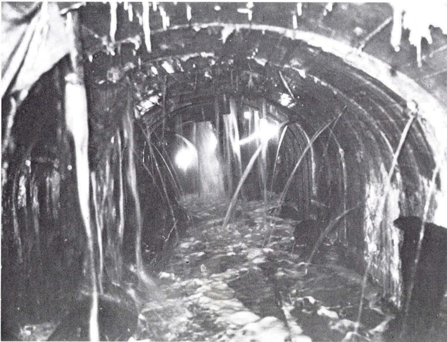
Fig. 57: Svanemølle-tunnelen. Knust strækning nær land. 1943. Venligst udlånt af Alfred Rosenkrantz.
